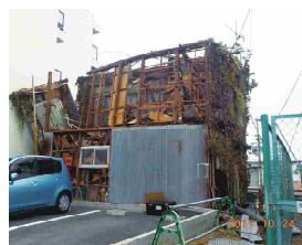
(神戸市内：台風による空き家の倒壊)
